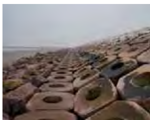
国外の援助によって設置された堤防 (ベトナム・ハイハウ)
